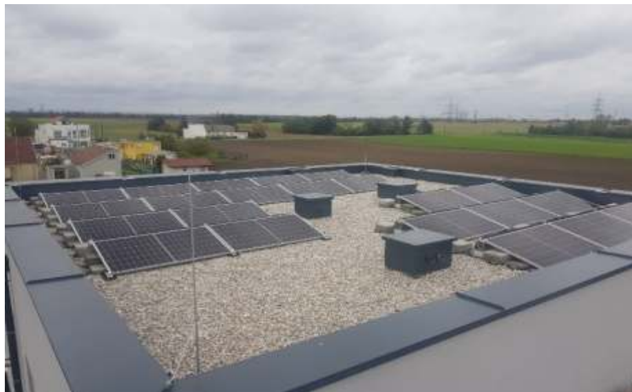
Erneuerbare Energie vom Dach
