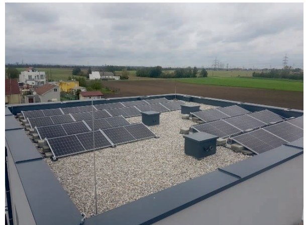
Fotovoltaik Anlage auf der Kläranlage
